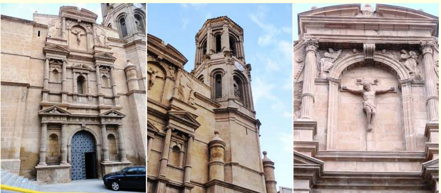
1 Fachada con los tres órdenes arquitectónicos griegos: dórico, jónico y corintio. 2 La torre fue construida en 1660 siendo los dos primeros cuerpos de piedra y los dos siguientes de ladrillo. 3 Cristo crucificado entre unos ángeles. Fachada claramente Manierista.
