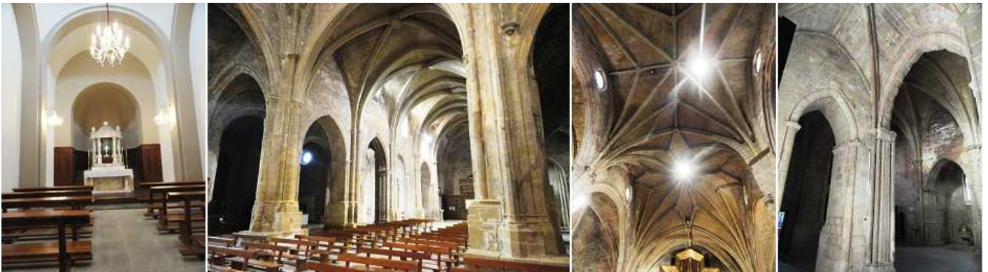
❶ Capilla de la Vera Cruz, la cruz de 20 x 18 está en un relicario de oro y plata del S. XVIII. ❷ - ❸ Detalle de las bóvedas de la nave central. ❹ Un detalle de las naves laterales.
